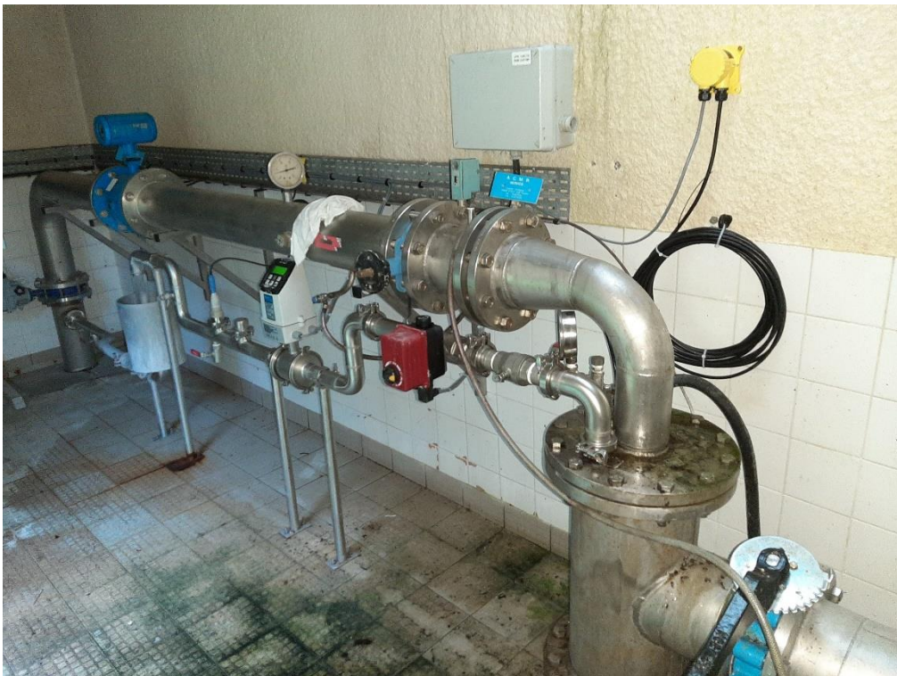
Vue de la tête de puits et de la manchette de mesure le 15/10/2020
