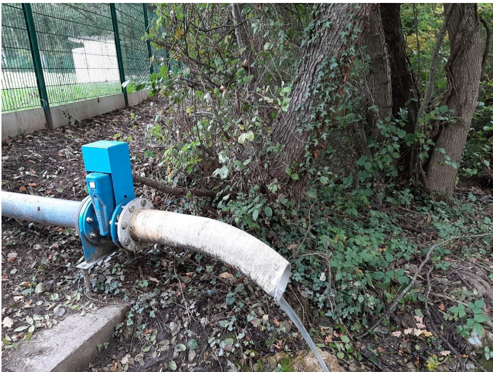
Vue du point de rejet au milieu naturel le 15/10/2020
