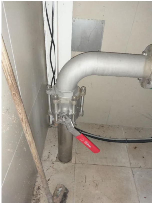
Position de la vanne lors de la visite
