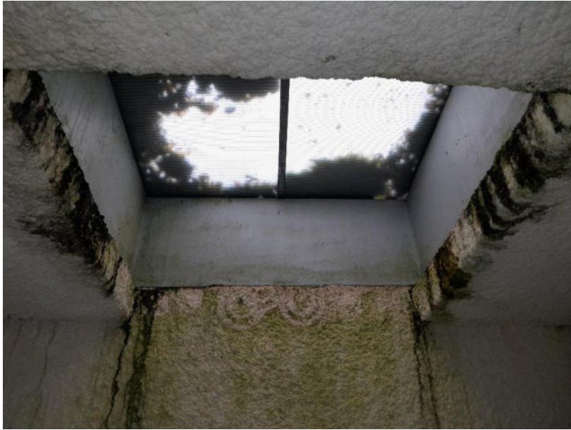
Vue état du skydome
