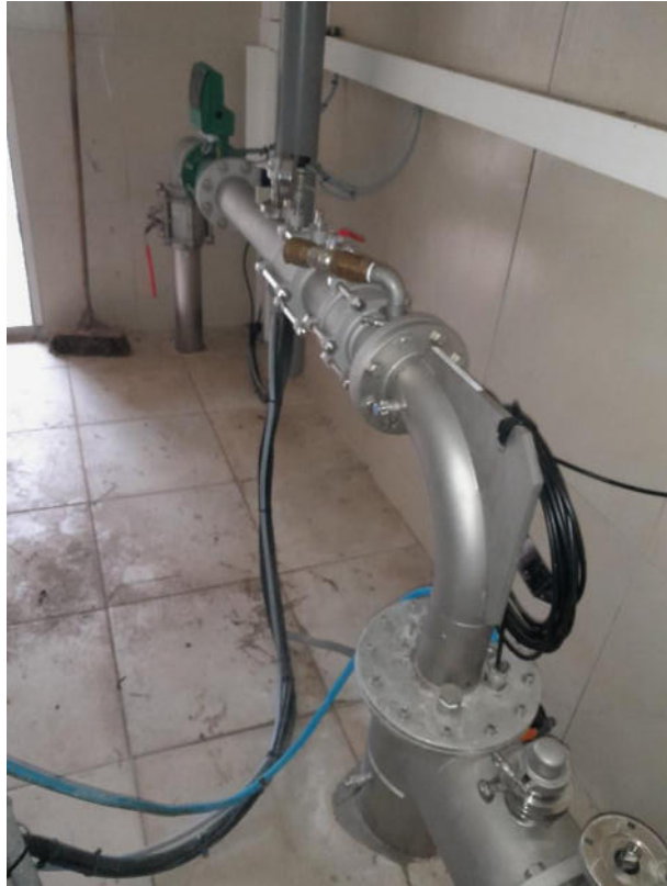
Vue de la tête de puits
