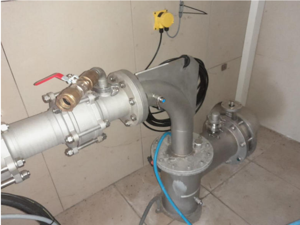
Vue du té de décharge sur la tête de puits (fermé)
