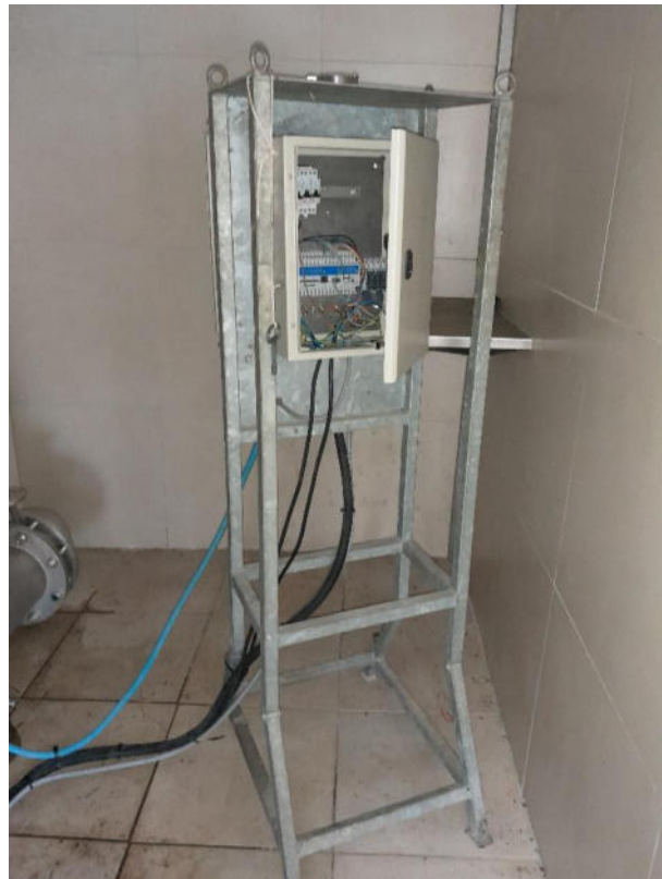
Vue de l'armoire de puissance
