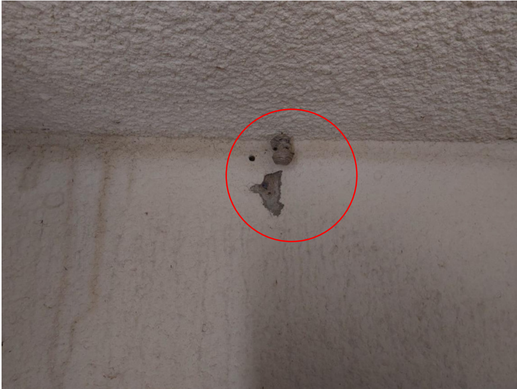
Vue ouverture dans le mur et nid insecte ?
