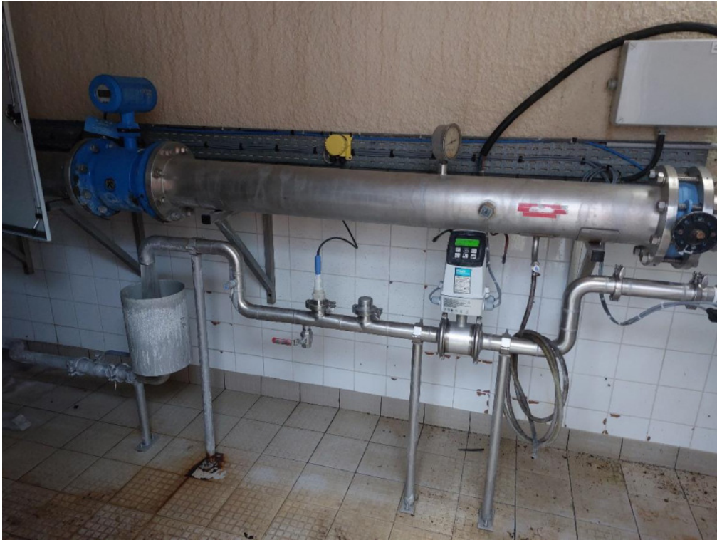
Vue du débordement du pot de dis connexion
